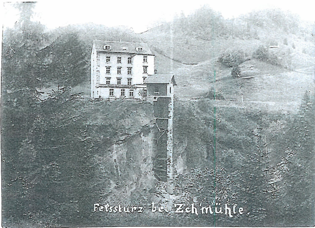
Ein Felssturz zerstörte um 1900 teilweise das Gebäude, das die Transmission vom Turbinenhaus zur Mühle und späteren Zwirnerei schützte.
